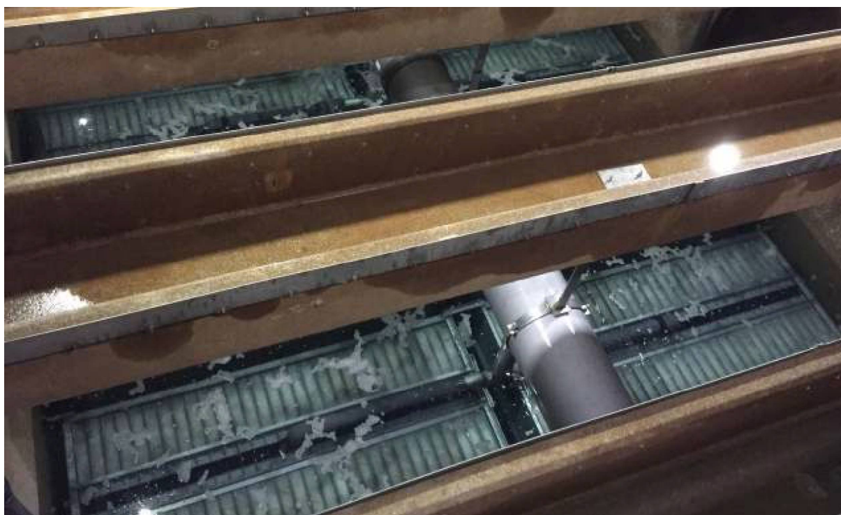
Figura 13: Filtro de areia convertido em sistema de UF em Lorne Park (Canadá).
