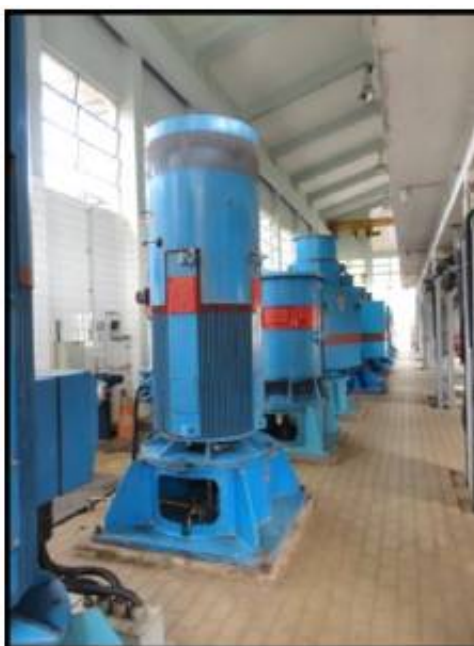
Figura 3: Conjuntos motobomba da captação existente
