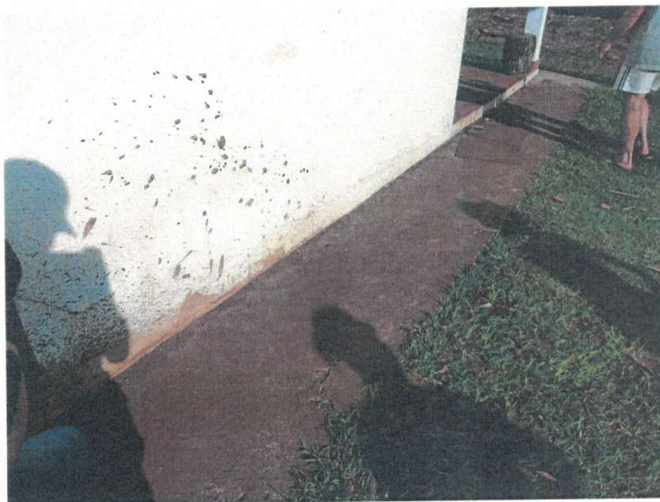
Figura 4 - Vista Geral da área externa (fissuras e trincas).
