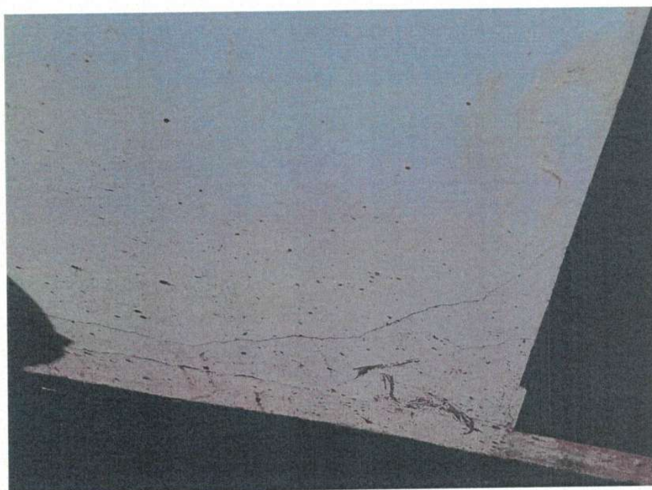
Figura 5 - Detalhes das fissuras e trincas na área externa.
