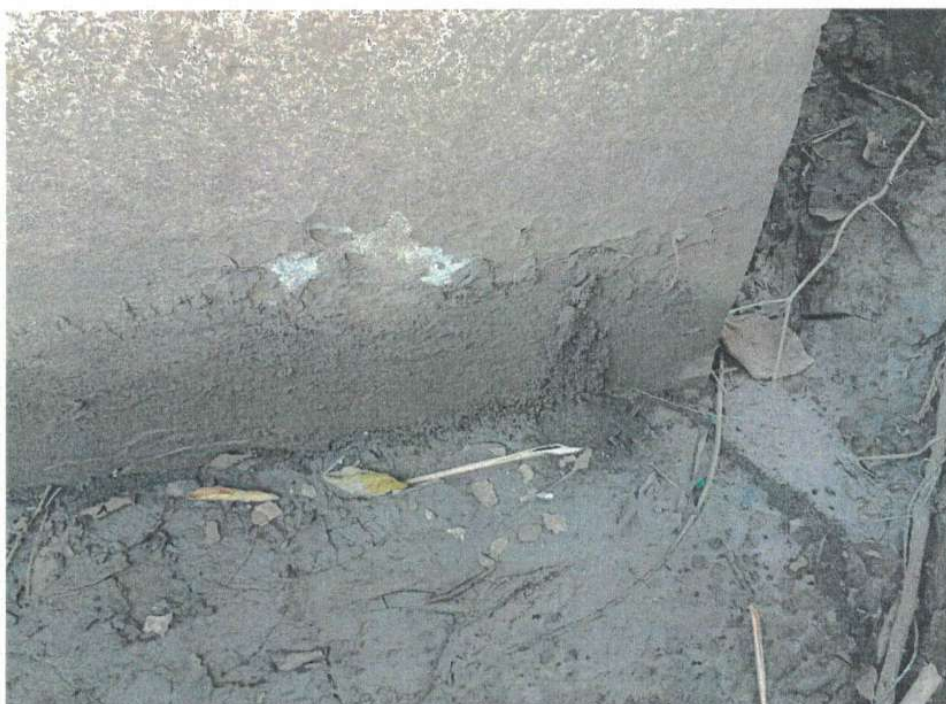
Figura 8 - Detalhamento danos na pintura.
