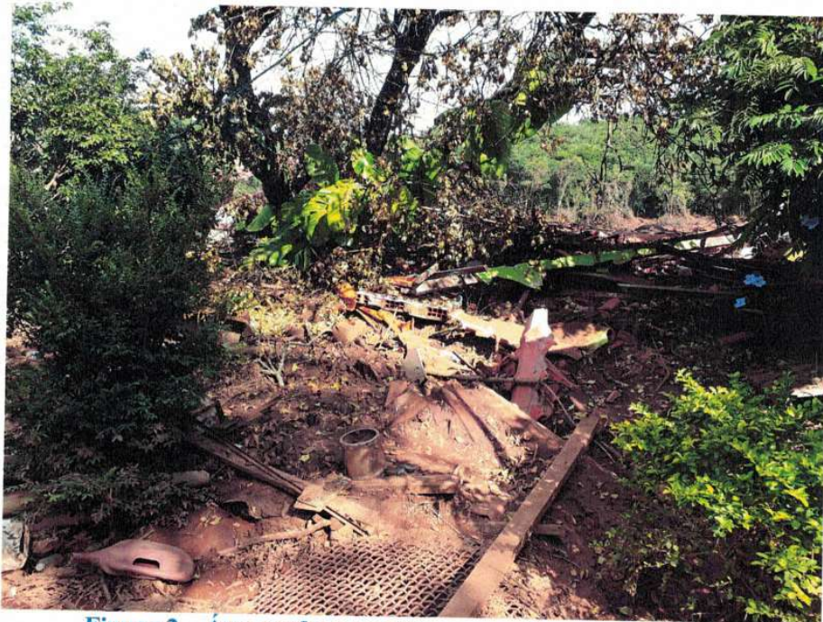
Figura 2 – Área onde encontra se escombros da residência.
