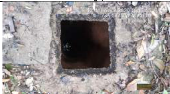
Foto 10: Cisterna dentro do Buffer de 100 metros do rio Paraopeba e com uso Restrito
