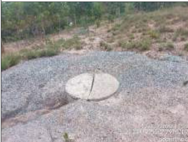
Foto 05: Poço Artesiano Comunitário.
