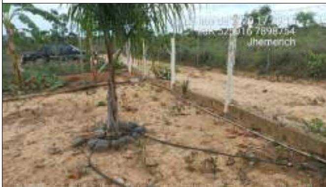
Foto 03: Encanamento de água de poço Artesiano Comunitário
