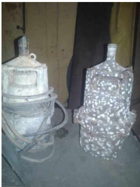
Figura 9 : A bomba d'água à direita foi retirada do rio Paraopeba (município de Papagaios) no mês de maio/2019 e observa-se que todo o seu revestimento externo foi corroído pelo contato direto com a água do rio. A bomba à esquerda, utilizada no rio Paraopeba antes do rompimento da barragem B1, apresenta revestimento intacto, servindo como base de comparação.
